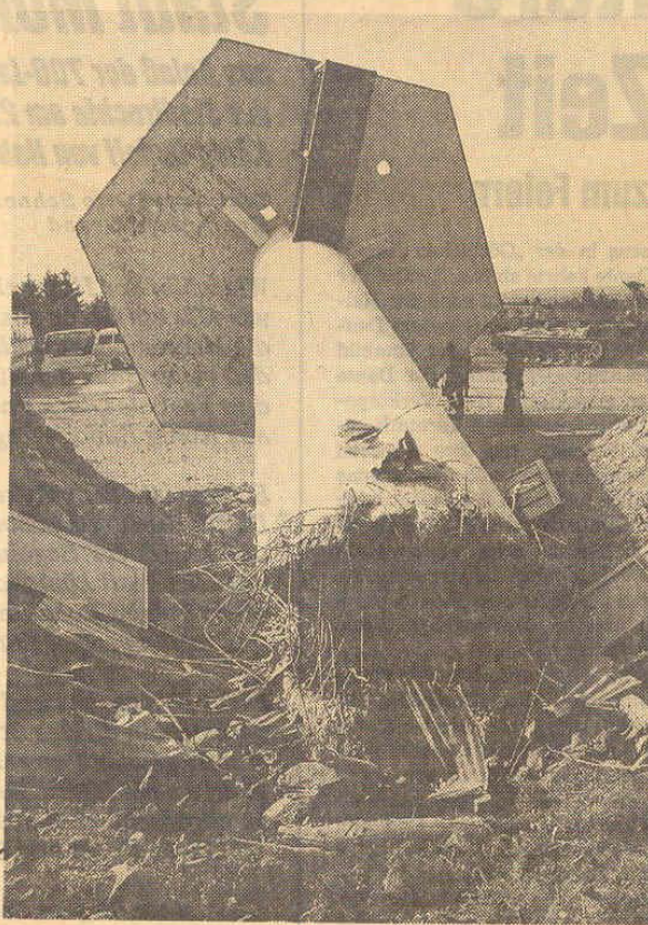
Wie geplant kippte bei der Sprengung der ausgediente Radarturm der ehemaligen Flugabwehranlage Obersayn in der Gemarkung Weidenhahn.
